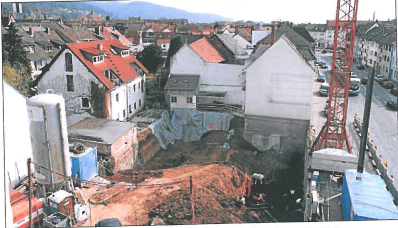
Aus der tiefen Baugrube an der Dossenheimer Landstraße soll bis 2011 ein Wohn- und Gewerbeobjekt wachsen. Foto: Kaz
