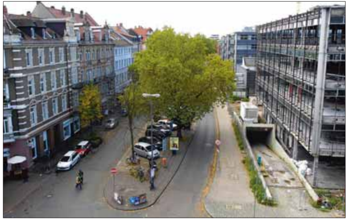
angenommen. Erst wird das alte Finanzamt (rechts) abgerissen. Dann wird das Unternehmen Züblin für den Auftraggeber, das Land Baden-Württemberg, neu bauen. Die Bahnhofstraße wird dann schmaler werden, die Bäume und Parkplätze fallen weg. Foto: Hentschel/Kresin
