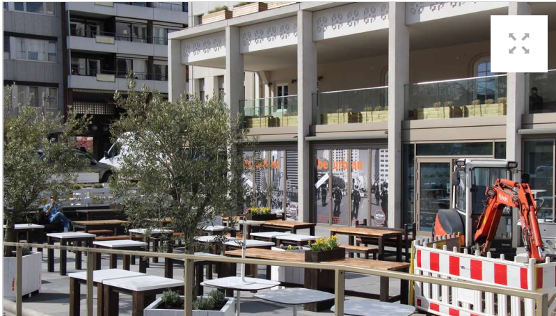
Künftiges Domizil für das KÖRPERWELTEN-Museum: Das Alte Hallenbad in der Poststraße. © HEIDELBERG24/Josefine Lenz
